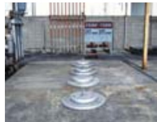
鋼製地下タンク
