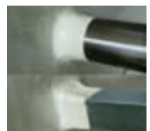
配管周り納まり部
