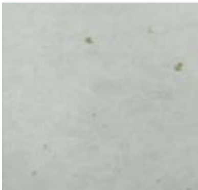
腐食環境分類Ⅱ類・H 2 Sガス濃度が10~50ppm環境下にて10年経過 多少の変色が見られる程度
