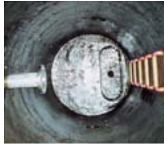
マンホールポンプ
