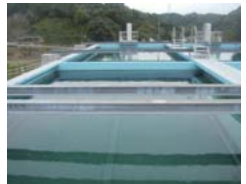
沈殿池 外部屋外仕様
