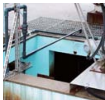
浄水場混和池 20年経過状況
