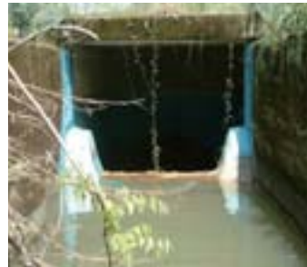
サイホン 20年経過状況
