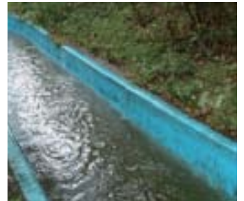
農業用水路 20年経過状況
