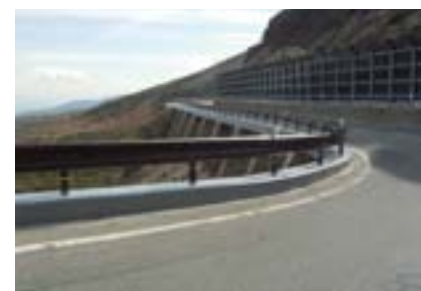
山岳地道路 劣化防止 塩害対策
