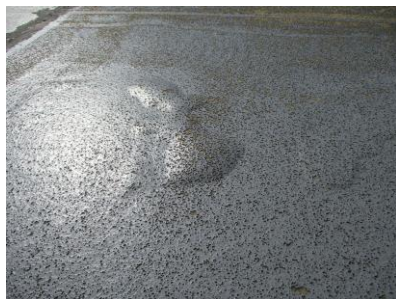
施工前（既設防水層膨れ）
