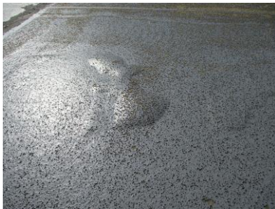
施工前（既設防水層膨れ）
